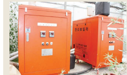
에너지 절감을 위해 72kw급 탄소보일러(3대/0.66ha)를 설치
