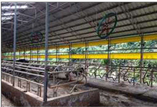
<우사 송풍팬 설치>
